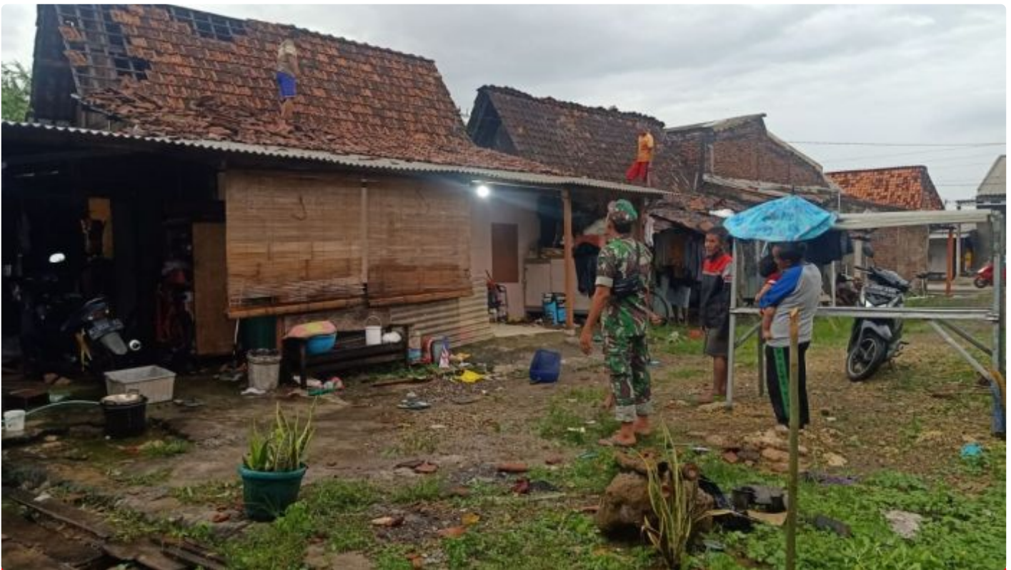
Babinsa Koramil 13/Karangawen Cek Rumah Rusak Akibat Puting Beliung
